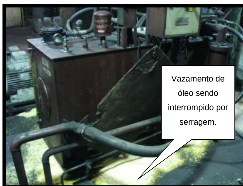
Figura 27 – Vista parcial de uma das salas hidráulicas. Fonte: Arquivo pessoal
