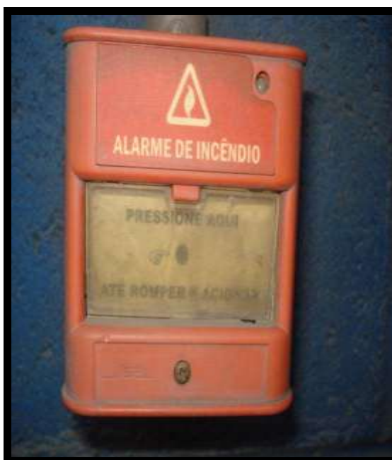
Figura 7 – Vista de uma das botoeiras do sistema de alarme.
