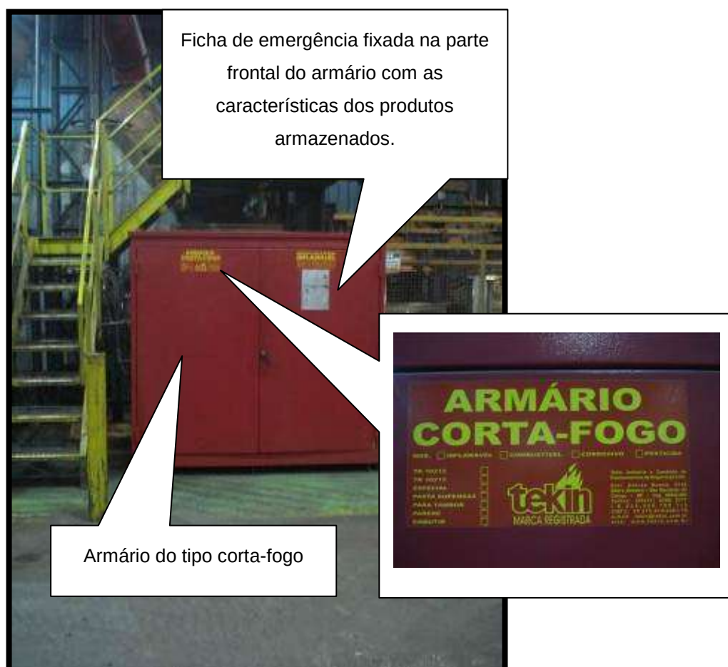
Figura 19 - Vista do armário corta-fogo.
