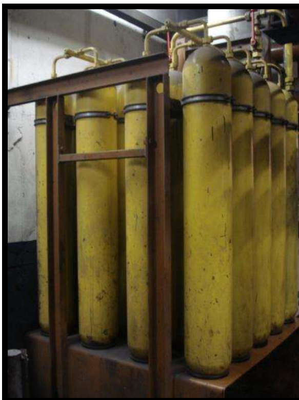
Figura 13 – Vista da cesta de cilindros de nitrogênio. Fonte: Arquivo pessoal
