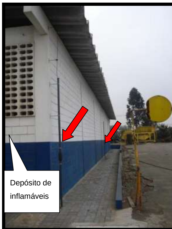
Figura 8 – Vista das descidas do SPDA no depósito de inflamáveis. Fonte: Arquivo pessoal
