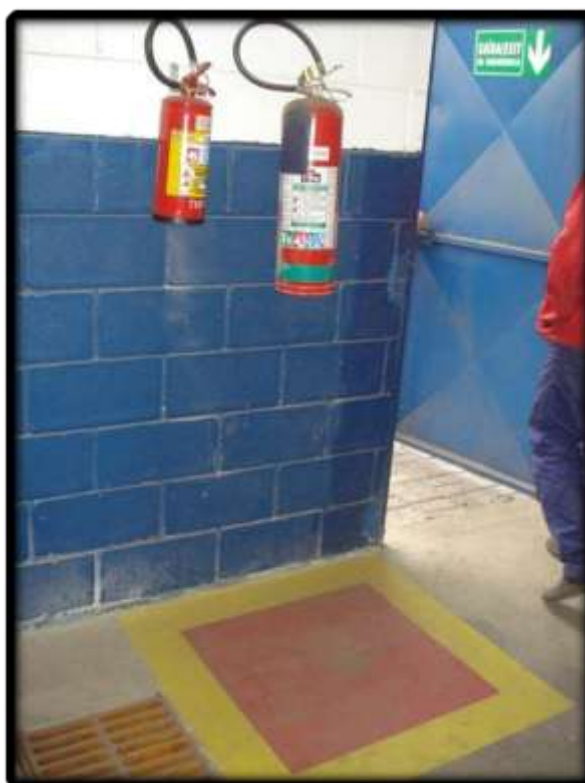
Figura 3 - Extintores de incêndio instalados corretamente. Fonte: Arquivo pessoal
