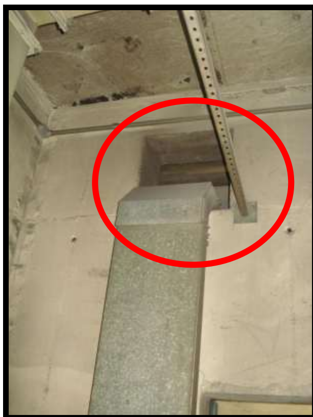
Figura 28 – Eletrocalha entre ambiente com passagem desprotegida. Fonte: Arquivo pessoal
