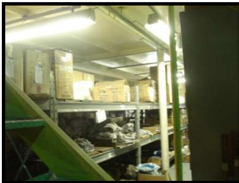
Figura 31 – Vista de caixas de papelão próximas das luminárias. Fonte: Arquivo pessoal
