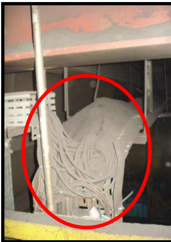
Figura 25 – Instalação elétrica com acúmulo de areia. Fonte: Arquivo pessoal
