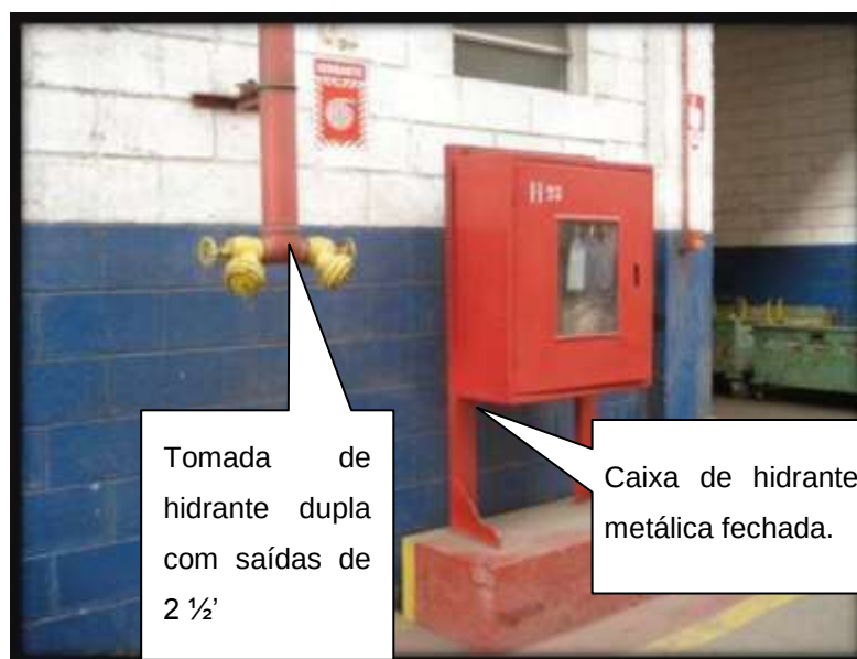
Figura 4 - Vista de um dos hidrantes, com abrigo fechado e sem lacre. Fonte: Arquivo pessoal
