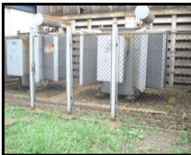
Figura 9 – Vista de dois transformadores instalados ao ar livre. Fonte: Arquivo pessoal
