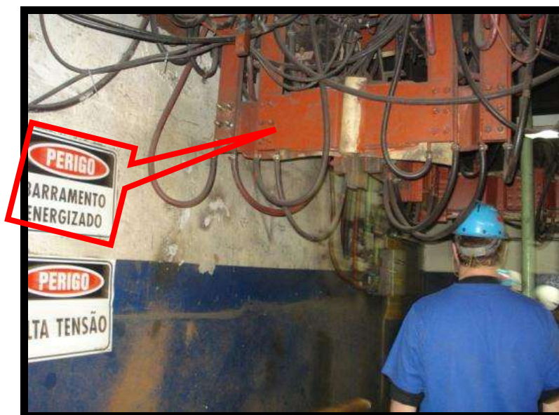
Figura 26 – Barramento energizado sem proteção. Fonte: Arquivo pessoal
