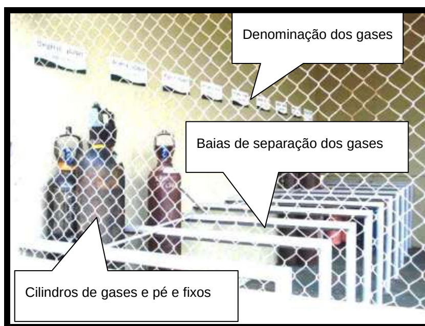
Figura 12 – Vista da área destinada ao armazenamento de gases. Fonte: Arquivo pessoal
