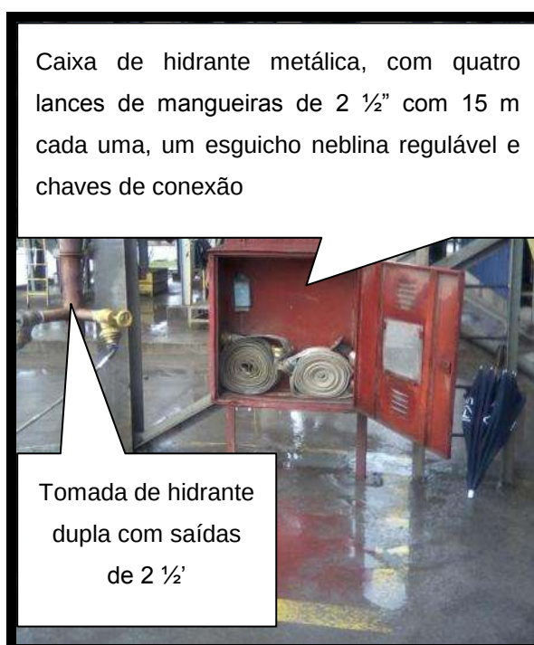
Figura 5 - Vista da tomada utilizada no teste de vazão. Fonte: Arquivo pessoal
